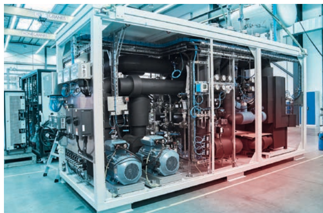
Die Lauda Kryopac Sekundärkreisanlage im offenen Zustand. Alle Komponenten werden vor der Auslieferung aufwändig von Hand isoliert.
