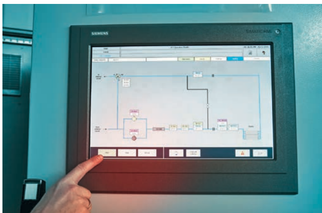
Die Lauda Kryopac Anlage lässt sich über ein Display intuitiv einstellen und bedienen.
