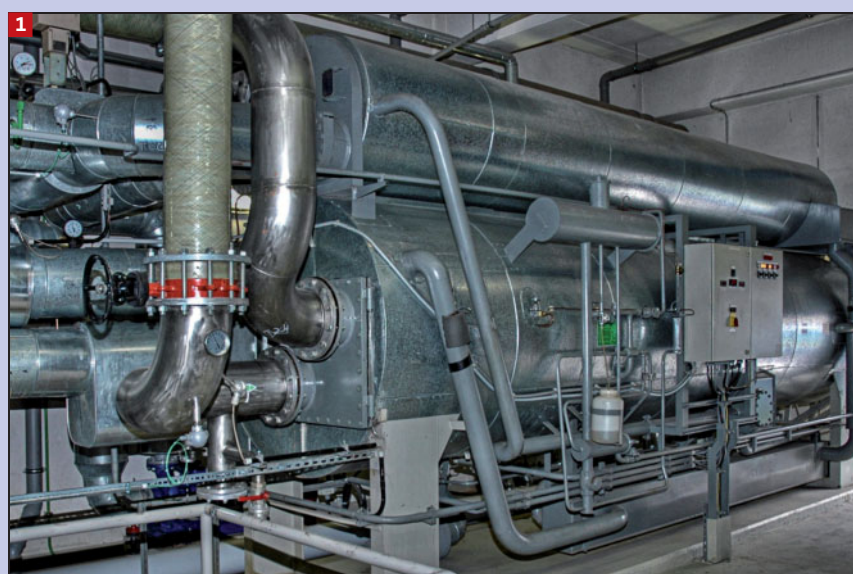
1 Einstufige H 2 O-LiBr-AbKM der Firma Carrier Typ 16 JH 065 (vgl. mit Tab. 1), Zentrale Kälteversorgung Chemnitz
