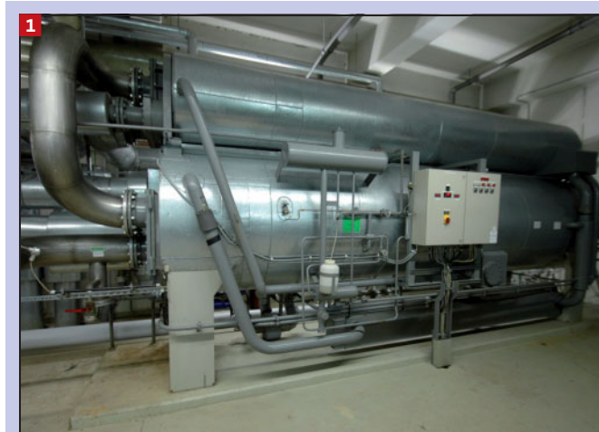
1 Einstufige H 2 O-LiBr-Absorptionskältemaschine der Firma Carrier Typ 16 JH 065 (vgl. mit Tab. 1), Zentrale Kälteversorgung Chemnitz
